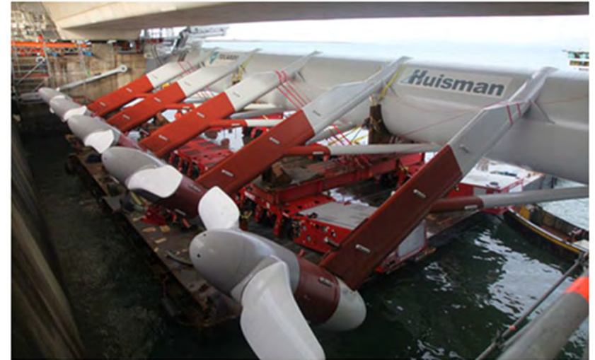
Tocado turbines succesvol geïnstalleerd september 2015
